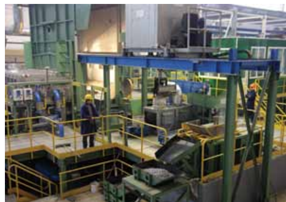
Новое оборудование линии горячего цинкования.
