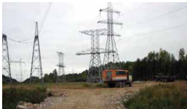
ПС 220/10 кВ АННА с заходами ВЛ 220кВ (Шлейфовый заход первой цепи ВЛ 220 кВ Рефтинская ГРЭС –Травянская на ПС АННА)
